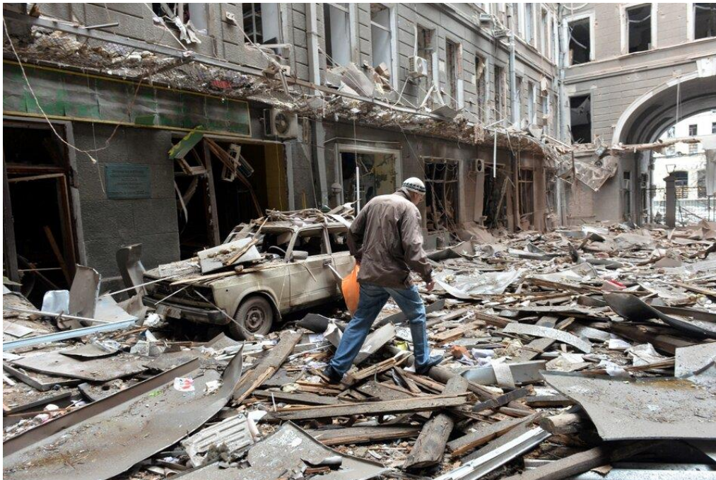
Un hombre camina sobre los escombros de un edificio bombardeado en Kharkiv (Ucrania) Imagen: AFP.
